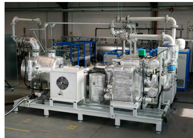
Anlage, Foto SPH GmbH
