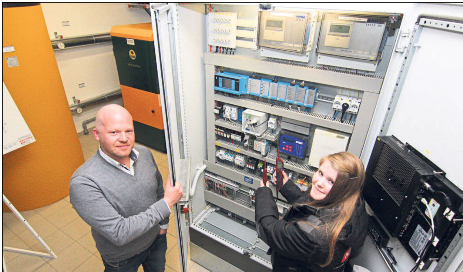
Theresa Rüsing (17) mit Niewels-Geschäftsführer Christoph Niewels vor der Steuerungsanlage für das firmeneigene Gebäude in Bad Lippspringe. Sie ist OWL-weit die erste Auszubildende als Elektronikerin für Gebäude- und Energietechnik.
